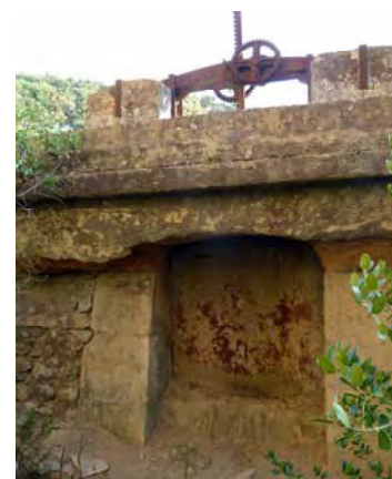
VANNE DE DÉCHARGE
