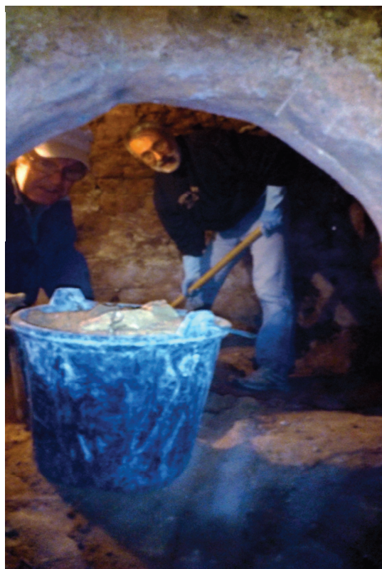
Stéphane et Simon sont courageusement entrés à l'intérieur du four pour déblayer la sole
