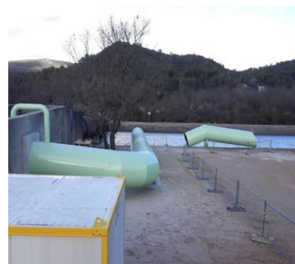
Tuyau pour rejeter l'eau dans le canal mixte
